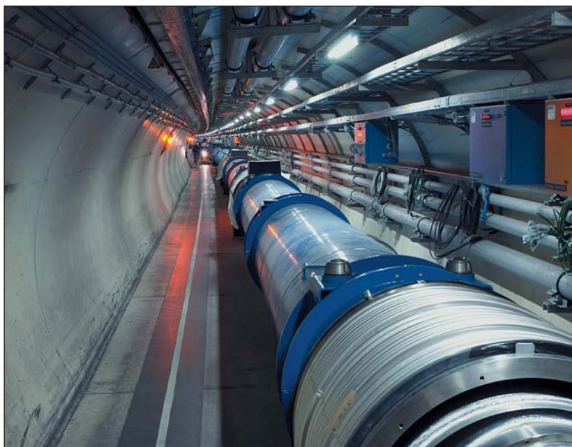
Полным ходом идет сборка и соединение основных магнитов ускорителя LHC в 27-километровом подземном туннеле.
